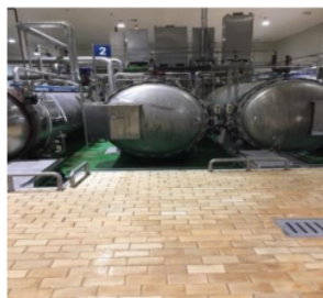
Figura 25. Sala de cocción de los lomos. Autoclave Fishban
