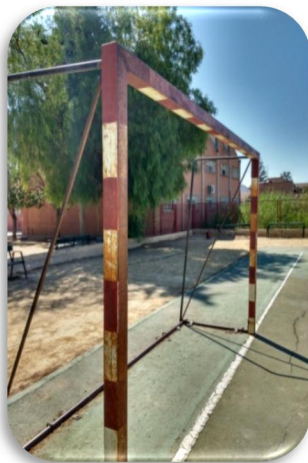
Figura 4.27. Portería con mal estado de la pintura y signos de oxidación.
