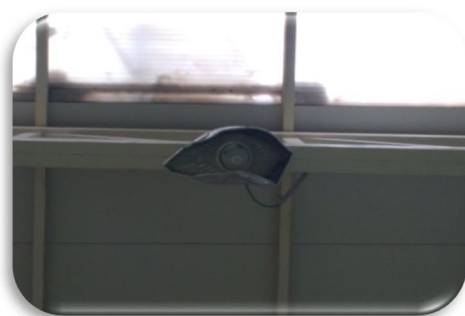
Figura 4.8. Luminaria no resistente a los impactos.
