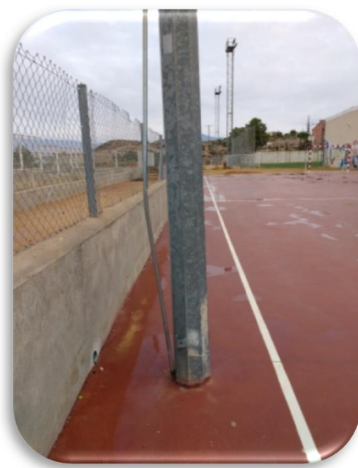
Figura 4.15. Báculo de iluminación dentro de la banda de seguridad.
