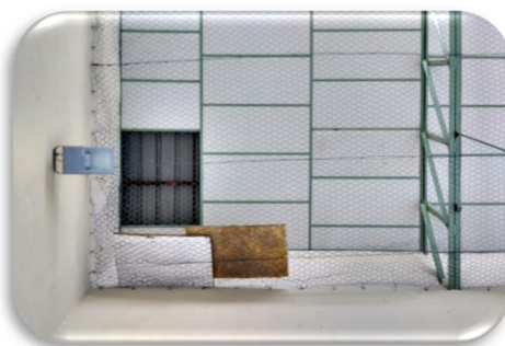
Figura 4.7. Techo en mal estado.
