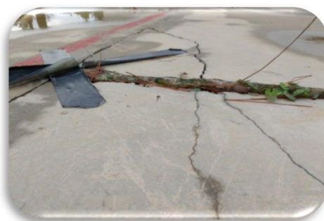
Figura 4.10. Zona de riesgo en pavimento señalizada.
