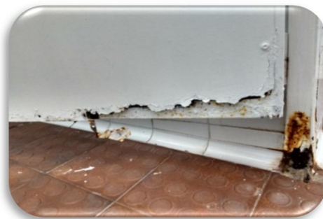
Figura 4.23. Puerta no resistente a la humedad con signos de oxidación.
