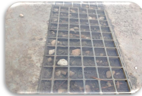
Figura 4.11. Canaleta de desagüe con acumulación de agua por mal estado de mantenimiento.
