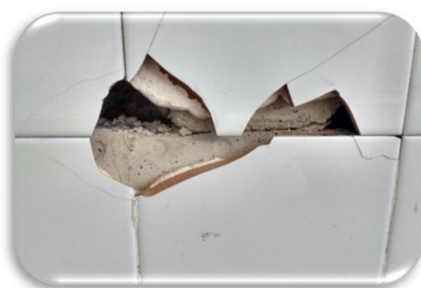
Figura 4.20. Rotura de revestimiento cerámico.
