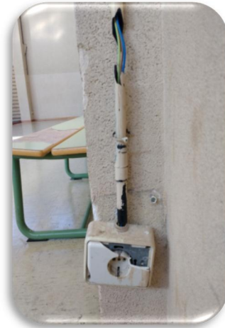
Figura 4.9. Instalación eléctrica en mal estado.
