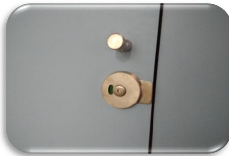
Figura 4.22. Pestillo con desbloqueo desde el exterior.
